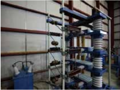
400kV衝撃耐電圧試験
