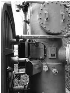
排ガス処理装置
