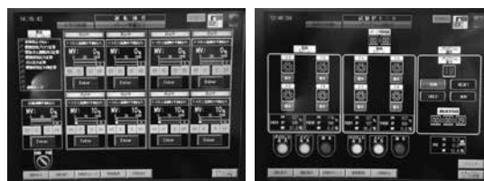
ガスコントロール画面 各バーナ操作画面 タッチパネル
