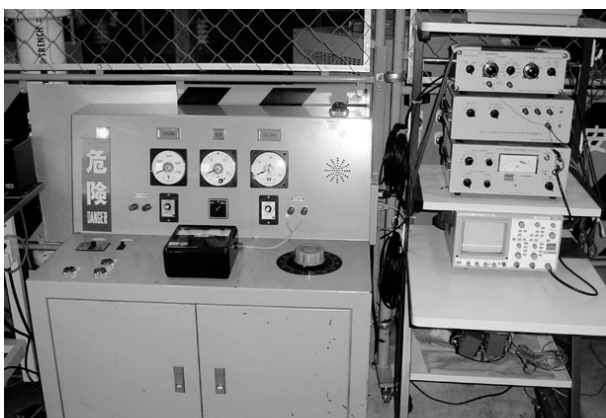
部分放電試験設備
