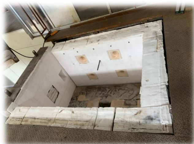
↑ 天板を取り外した状態
